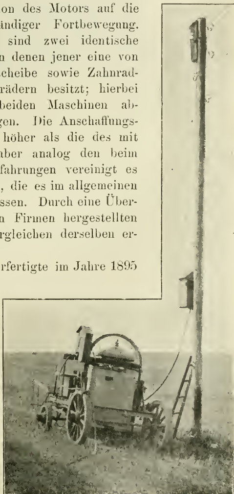
Fahrbarer Transformator, an die Hochleitung angeschlossen. (Phot. auf der Domäne Sillium bei Daneburg, Hannover A. P.)
