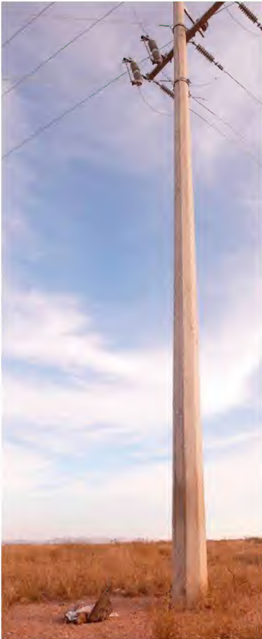
Figura 9. Aguililla de Swainson electrocutada bajo una terminal doble con puentes sin aislar. Foto: Rodrigo Sierra Corona.
